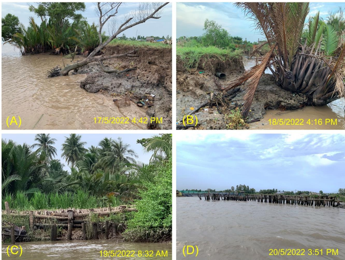
Hình 10. Sạt lở bờ sông Hàm Luông uy hiếp vườn cây ăn trái và ao nuôi thủy sản (A, B); và một số giải pháp khắc phục tạm thời của người dân địa phương (C, D). Vị trí hình ảnh được chụp trong chuyến khảo sát thực địa, tương ứng với các vùng A, B, C và D trong Hình 9e.
