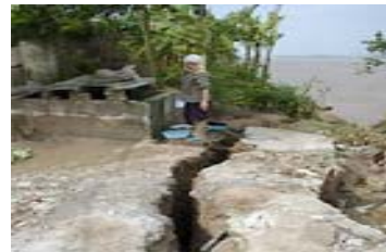
Hình 18. Vết nứt sụt sâu vào đất liền
