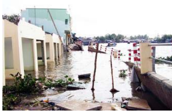
Hình 17. Sạt lở đất ở dọc bờ sông
