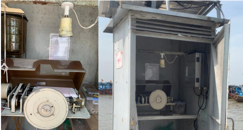
Hình 2. Vị trí lắp đặt camera tại Trạm thủy văn Mỹ Tho.
