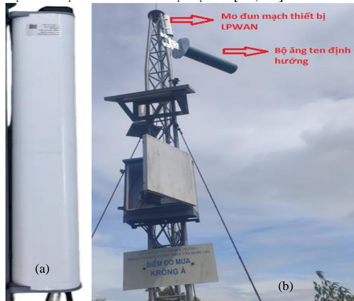
Hình 10. (a) Hình ảnh thực tế thiết bị modem LPWAN đặt trong hộp bảo vệ thiết bị theo tiêu chuẩn IP; (b) Hình ảnh toàn bộ modem LPWAN và ăng ten thực tế được lắp đặt tại trạm đo mưa tự động Krông Á, Đắk Lắk.
